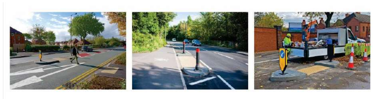
Figura 10-12. Islas peatonales prefabricadas en caucho
